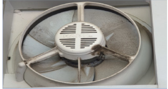
| 환기 시설 청결관리 미흡 |
