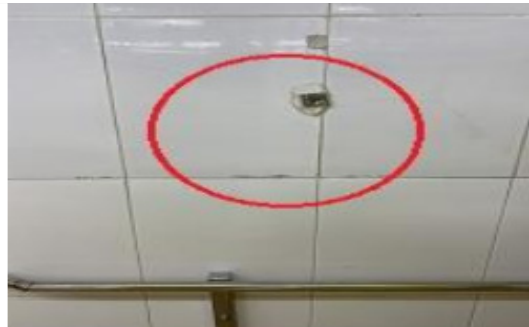
[미흡사례, 벽면 타일 파손]
